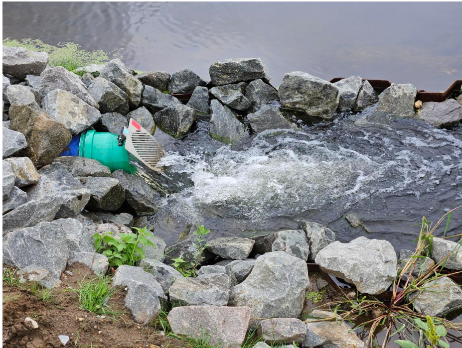
Bildquellen: Vortrag SW Wittenberge: „Praxisbericht zur Inbetriebnahme einer Flusswärmepumpe der Stadtwerke Wittenberge“ beim Fachsymposium „Umweltwärmenutzung aus Fließgewässern“ am 11.11.2025
