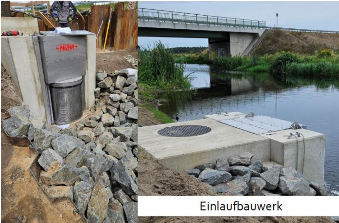
Bildquellen: Vortrag SW Wittenberge: „Praxisbericht zur Inbetriebnahme einer Flusswärmepumpe der Stadtwerke Wittenberge“ beim Fachsymposium „Umweltwärmenutzung aus Fließgewässern“ am 11.11.2025
