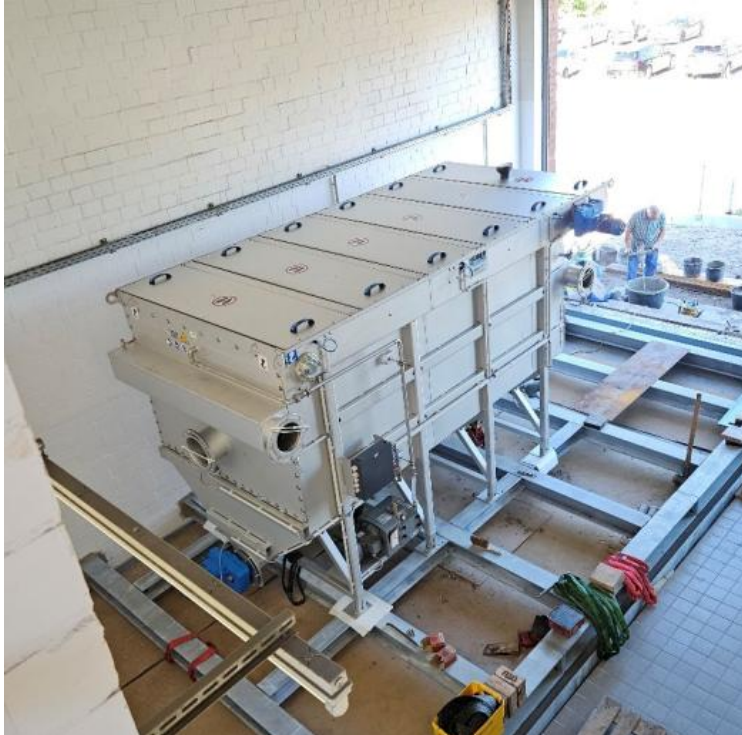
Bildquellen: Vortrag SW Wittenberge: „Praxisbericht zur Inbetriebnahme einer Flusswärmepumpe der Stadtwerke Wittenberge“ beim Fachsymposium „Umweltwärmenutzung aus Fließgewässern“ am 11.11.2025
